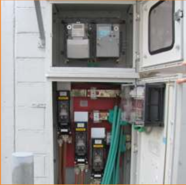
איור 4: ארון מערכת מנייה למיתקני מתח נמוך
